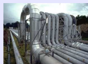
Plynovody pro přepravu zemního plynu
