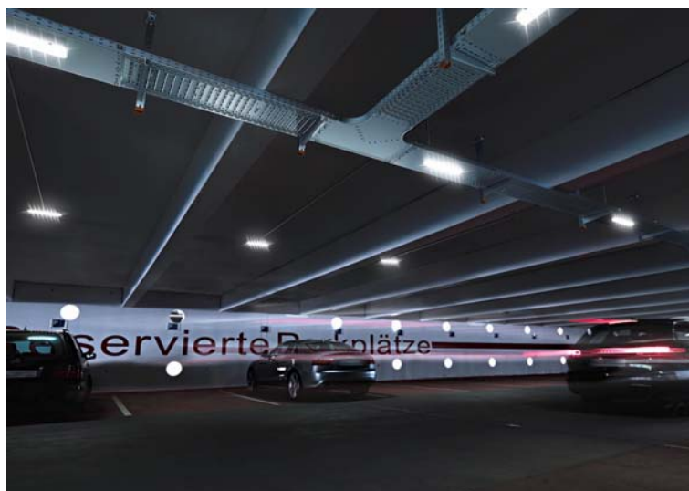
• Obrázek 6: LED osvětlovací tělesa Hella integrovaná v trase kabelových žlabů RKSM
