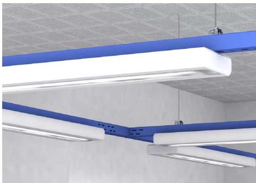
• Obrázek 4: Instalace osvětlovacích těles s nosníkem svítidel typu LTR na lanovém závěsu pod stropem
