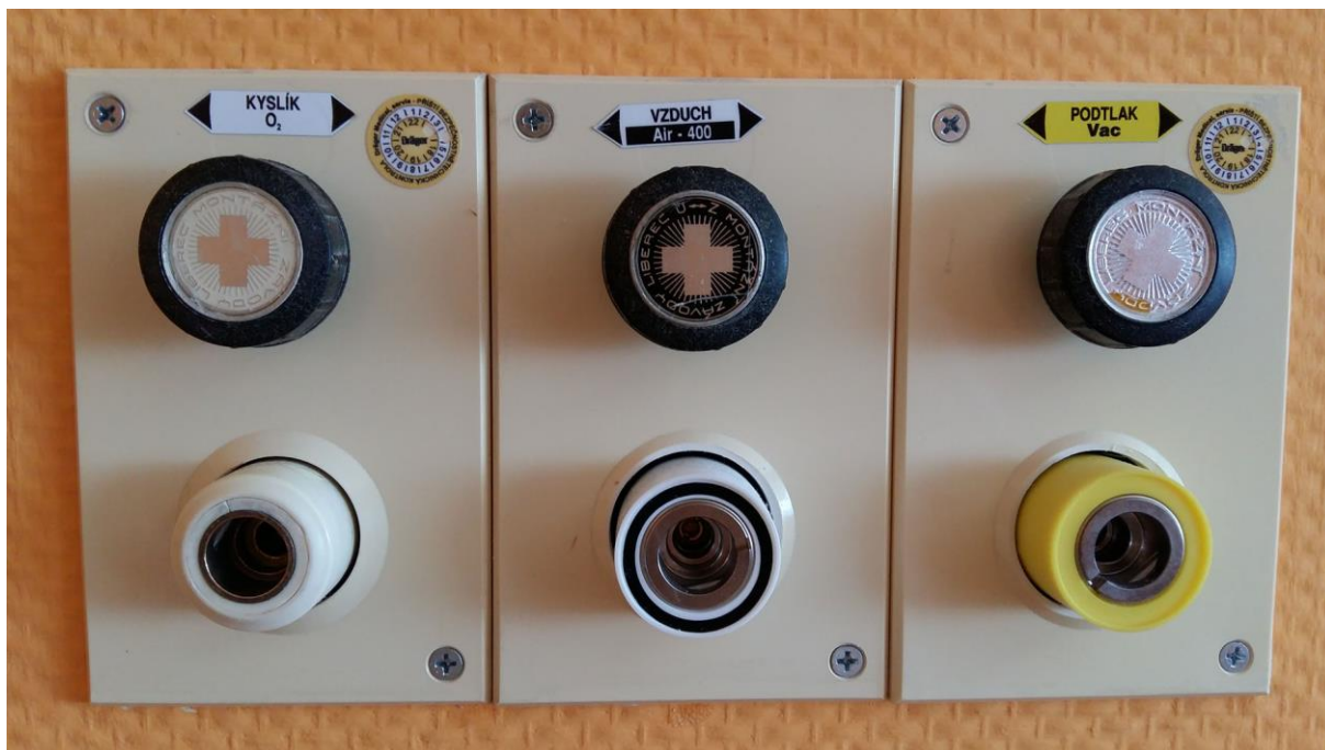
Centrální rozvod plynů
