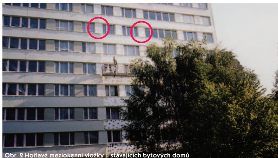
Obr. 2 Hořlavé meziokenní vložky u stávajících bytových domů
