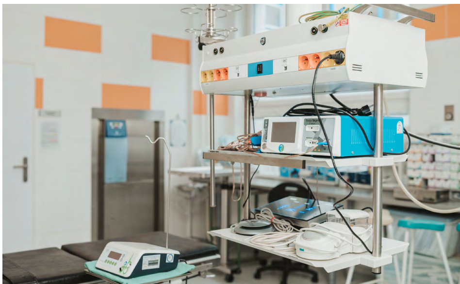
Část přístrojového vybavení operačního sálu
